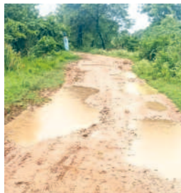
వర్షానికి గుంతలమయంగా మారిన మీరాపూర్ దర్గా రోడ్డు
